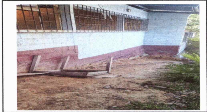
Foto2: Muro en forma de cuadrado en la parte donde termina el primer balcón.
